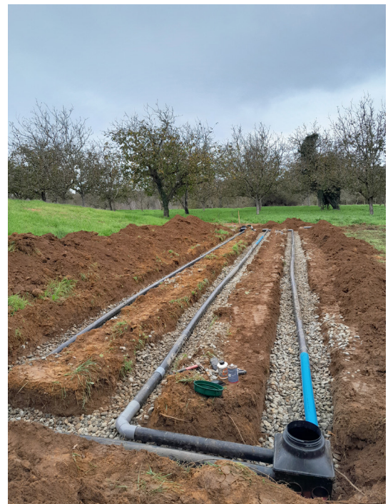
Photos : SPANC Communauté de communes Domme - Villefranche-du-Périgord
